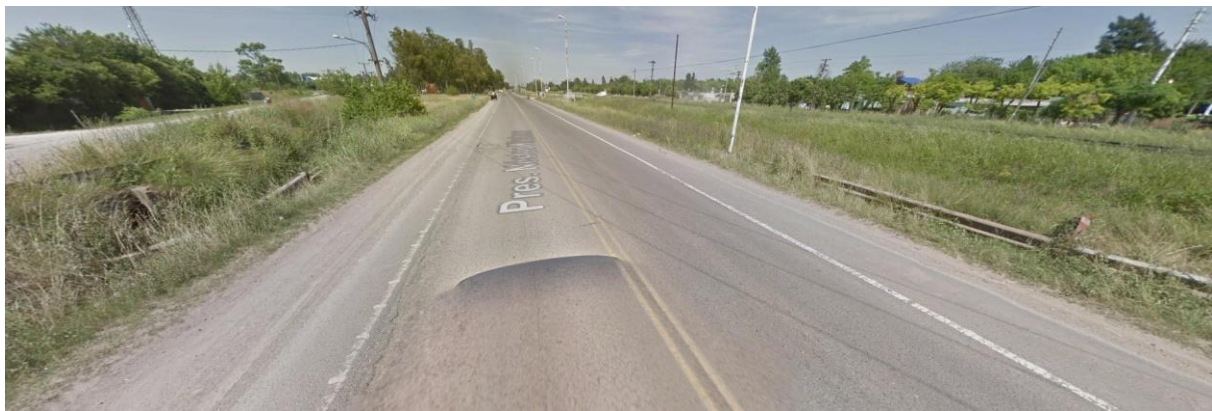
Imagen 12: Barandas metálicas a reemplazar en alcantarillas transversales.
