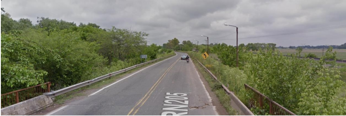
Imagen 11: Barandas metálicas a reemplazar en terraplenes de acceso a puentes.
