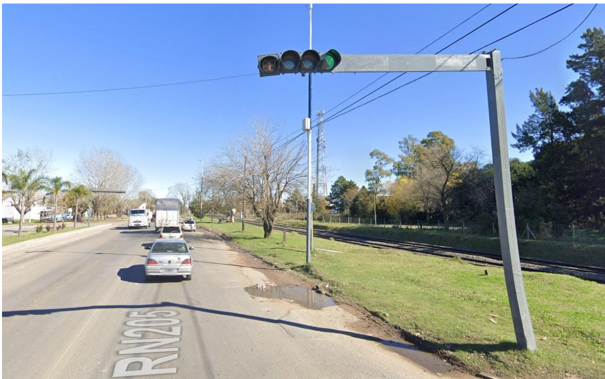
Imagen 14 y 15: Sistema de semaforización existente a readecuar y/o reemplazar.
